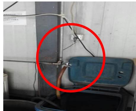
7.洗车间插座不防潮（更换成防潮插座或增加防潮盖）
