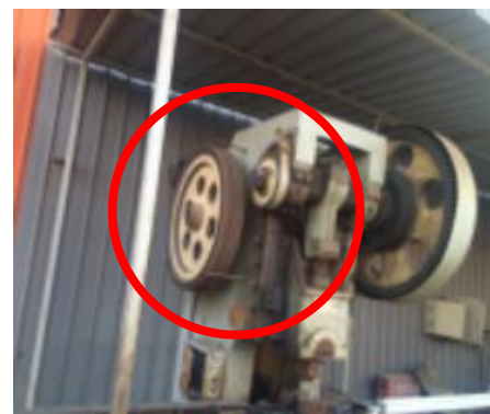
5.车间大型设备转动部位无防护罩
