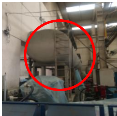
3.车间高于三米的钢直梯无护笼
