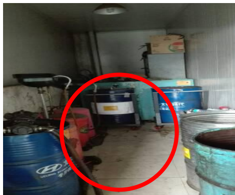
5.废油库防油胶垫未铺到位
